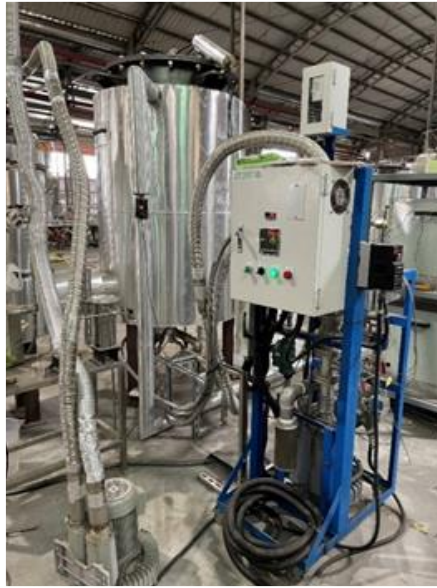
圖 10 本實驗所使用之鍋爐與操作面板
